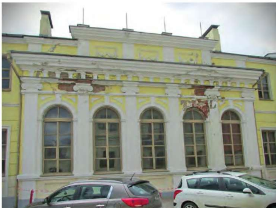
Ил. 5. Здание бывшего Дома еврейских свадеб и торжеств Черчеса, Раковская, 17. Современное состояние
